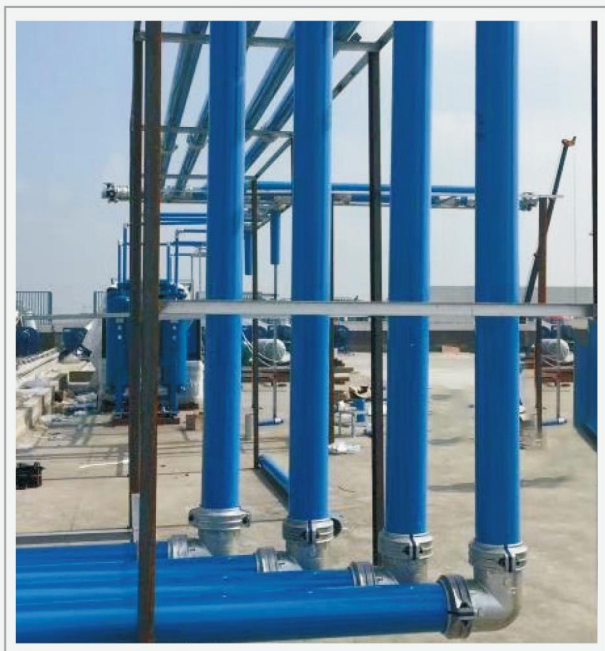
某玄武岩公司全性能铝合金压缩空气管路项目
