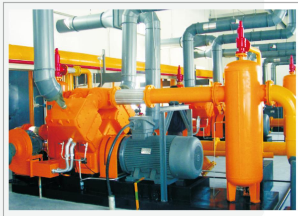
某油田天然气压缩机系统项目
